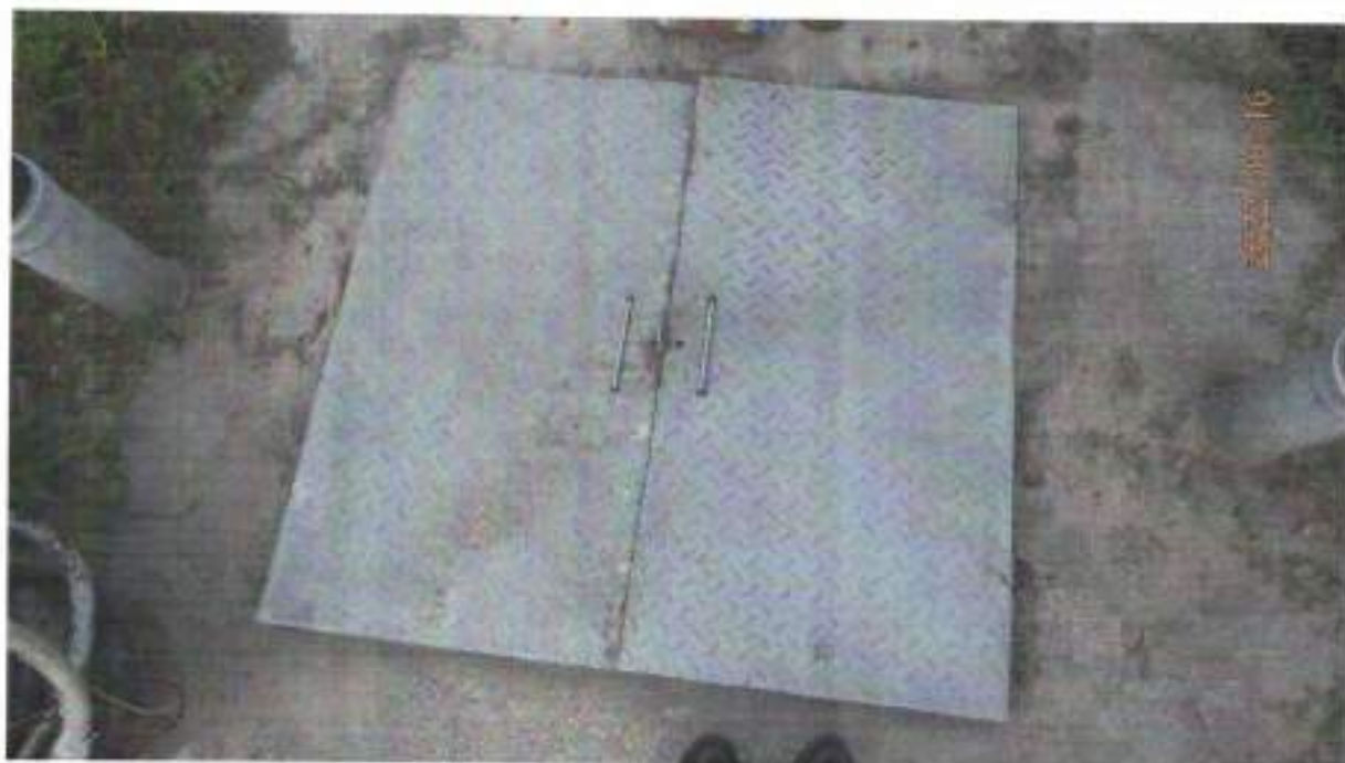
Zdj. 6 Przepompownia rondo Dybówek
