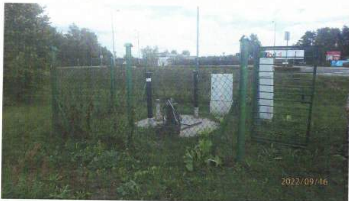
Zdj. 5 Przepompownia rondo Dybówek
